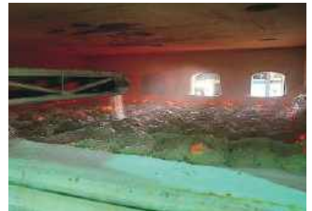
直接通電式ガラス溶融炉の内部
